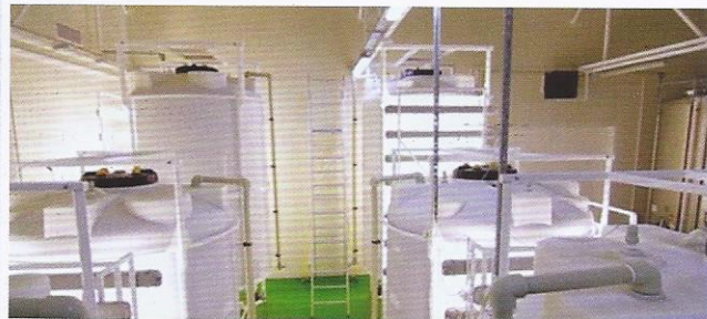
Fot. 2. Główne pomieszczenie technologiczne, Fot. I. Gebler
